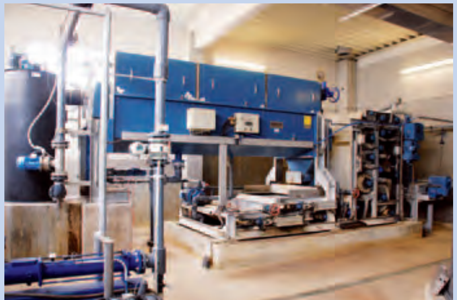
In die Jahre gekommen: Die alte Siebbandpresse wird durch eine neue Maschine ersetzt.
